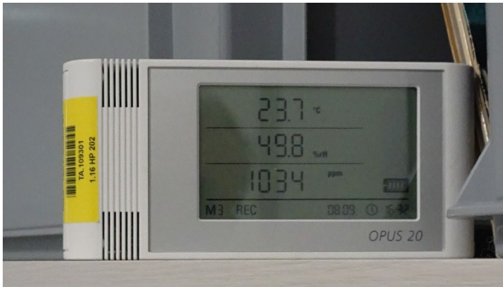
Abbildung 91: Datenlogger für Temperatur, Feuchte und CO2 (Schlaf- und Wohnzimmer)
