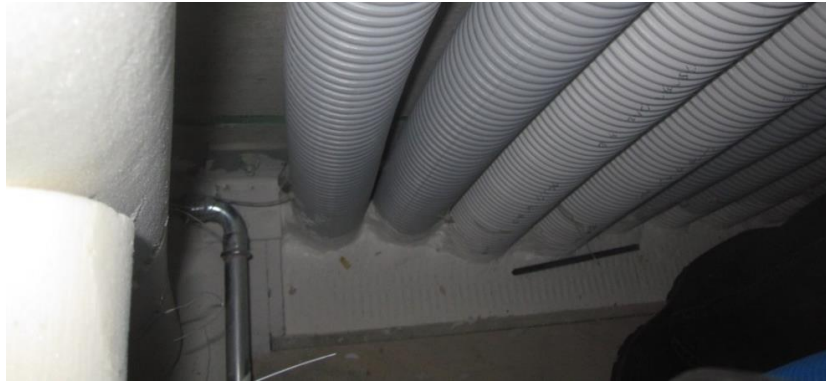
Figura 9: Vano tecnico verticale (Fonte: Hochschule Luzern – Technik & Architektur; Foto: 30.11.2013)
