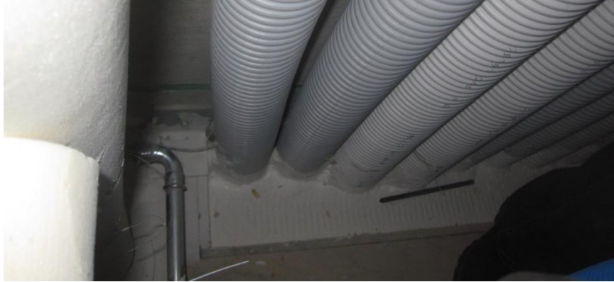
Abbildung 8: Steigschacht mit Installation (Quelle: Hochschule Luzern – Technik & Architektur; Foto: 30.11.2013)
