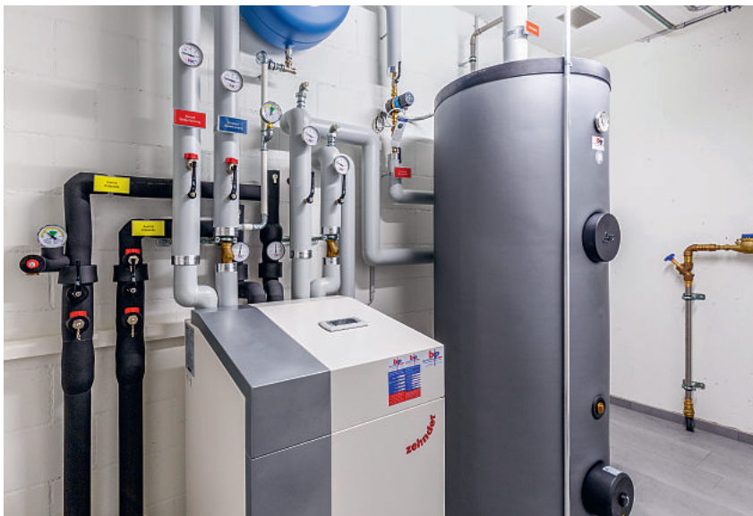
Abbildung links: Die Wärmeversorgung des Minergie-Zweifamilienhauses erfolgt über eine vollmodulierende Sole-Wasser-Wärmepumpe mit Passivkühlung via Erdsonde («free cooling»). Zusammen mit der Photovoltaikanlage auf dem Dach sorgt die im Keller installierte Wärmepumpe für angenehme Raumtemperaturen und Warmwasser.
