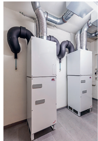
Abbildung rechts: Im Schmiedrueder Zweifamilien-Klimaholzhaus wurde pro Wohneinheit ein Zehnder-Lüftungsgerät im Keller installiert. Trotz seiner Leistungsstärke braucht das Zehnder ComfoAir SL 330 dank seiner äusserst kompakten Abmessungen nur wenig Platz und nimmt keinen Stauraum weg.
