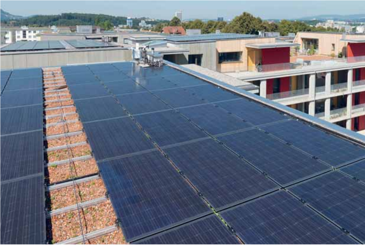
Abbildung 144: 1000 m 2 hybride So- larkollektoren pro- duzieren Strom und Wärme. (Bild: Chris- tine Blaser).
