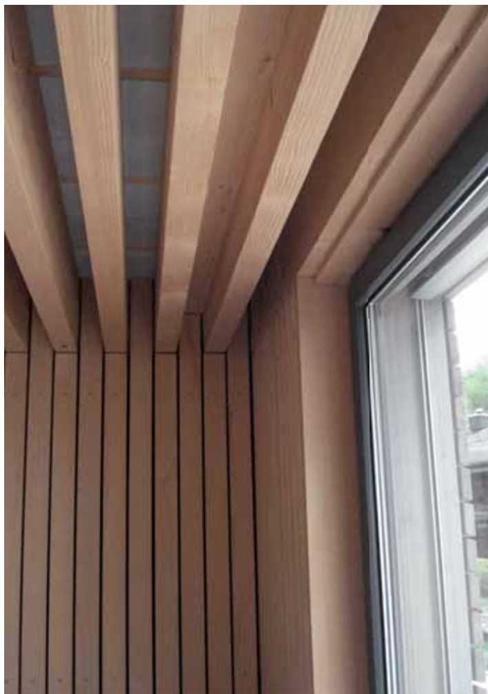
Abbildung 36: Die eng gerasterte Schnittholzspeicherdecke mit aufgelegten 7 cm starken Massiv-Kalksandsteinplatten und die 4 cm starke Schnittholz-Wandverkleidung bilden die Hauptspeichermasse im Minergie-P-Direktgewinn-Einfamilienhaus Jakob, Brienz, von Schilt, Langnau.
