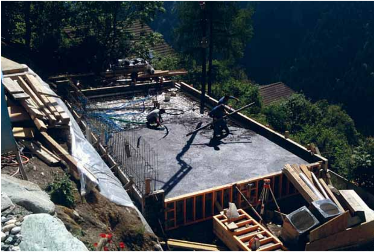
Abbildung 101 (links): Die Bodenplatte wird erstellt. Der Sichtbeton ist schwarz eingefärbt, damit er besser Wärme aufnimmt.
