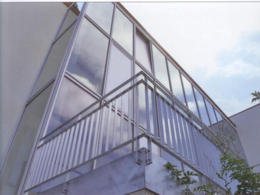
Le triple vitrage est posé dans des cadres bois-métal.
