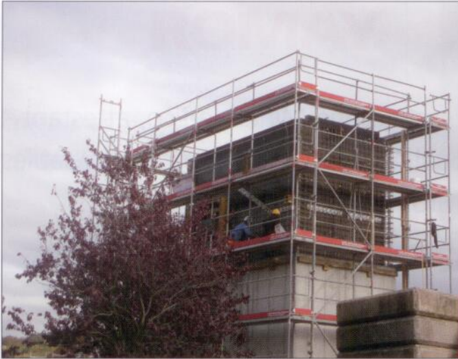
La cage d'escalier est fabriquée en béton recyclé et coulé sur place, la paillasse d'escalier et les éléments de coursive (sol et pilier) sont, eux, réalisés en béton préfabriqué.
