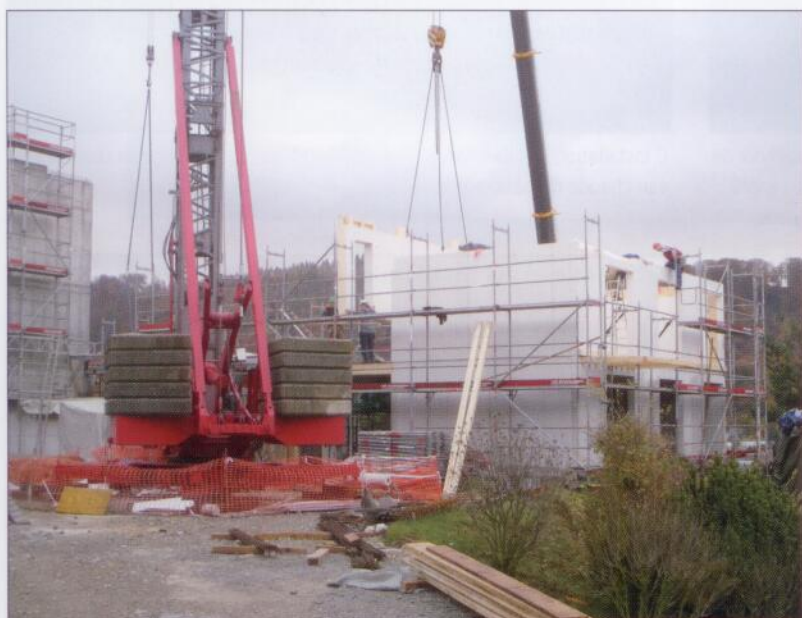
Les parois préfabriquées sont acheminées et posées. Le caisson préfabriqué se compose de deux panneaux trois-plies et d'une poutraison avec isolation en laine de roche.
