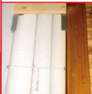
Canali di distribuzione tra la travatura
