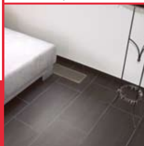
Una bocchetta di aspirazione dell'aria nel pavimento
