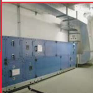
Apparecchio di aerazione centrale nella cantina di un edificio plurifamiliare
