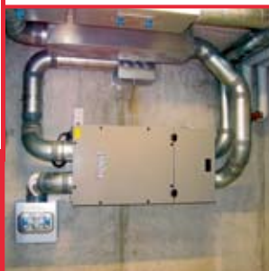
Un apparecchio di aerazione decentralizzato, montato nella cantina
