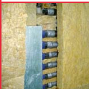
Canali di distribuzione d'aria posati nello spessore dell'isolamento termico
