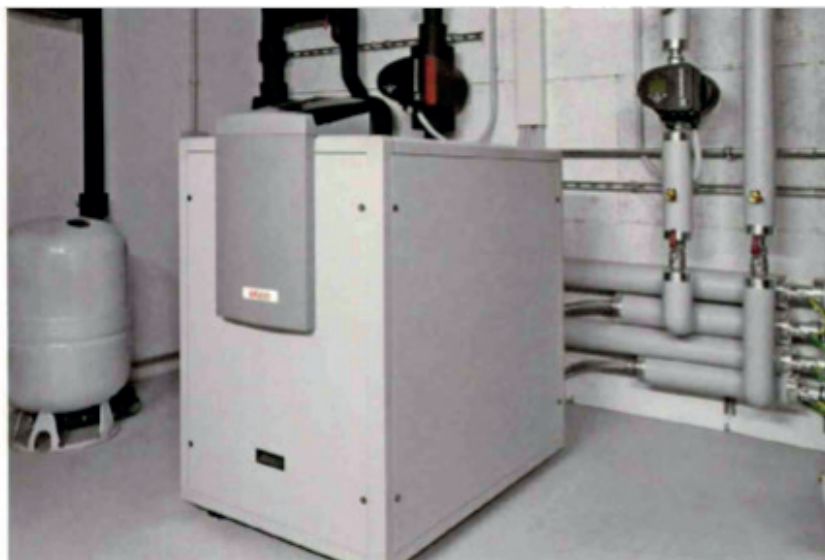
Blick in den Heizungskeller mit der Wärmepumpe Aquatop T, die für Heizung, Warmwasser und passives Kühlen sorgt.
