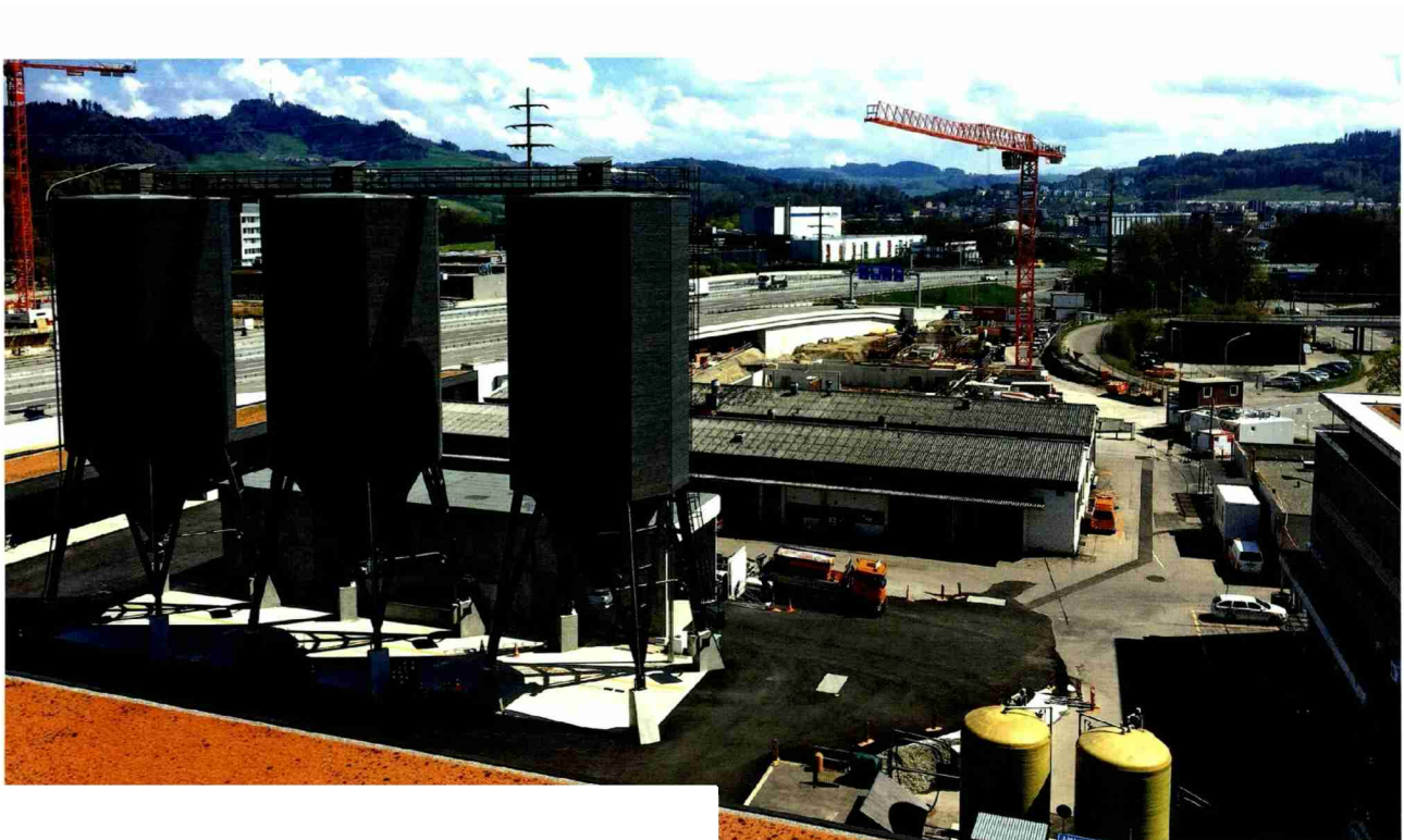
In Bern-Münsingen entstand innerhalb nur weniger Monate ein Paradebeispiel eines modernen Werkhofs mit nachhaltigem Charakter.
