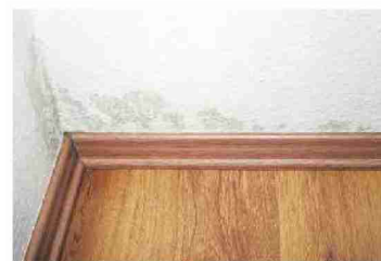
Schimmelpilz ist ein Alarmsignal.
