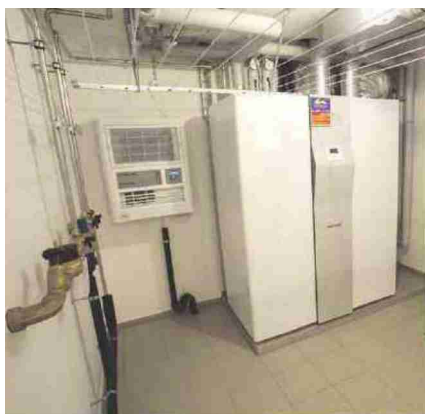
Leo Crapisi (unten) von der Gimag AG baut Häuser, die energieeffizient und gleichzeitig erschwinglich sind. Im Keller des Einfamilienhauses in Buus steht die Energiezentrale (oben), welche die Zusammenarbeit von Wärmepumpe und Photovoltaik steuert.
