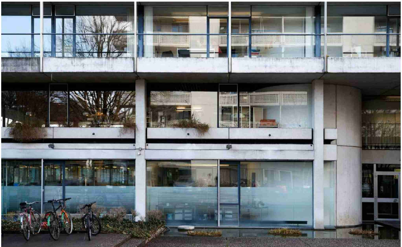
Das Gebäude der Erziehungsdirektion hat viele Fenster und wirkt dadurch leicht. Die Fassade ist geschützt, über die Balkone dringt im Winter aber Kälte nach innen.
