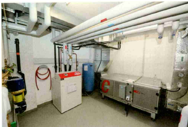
Eine schlanke Gebäudetechnik ist das Merkmal aller Minergie-Bauten.
