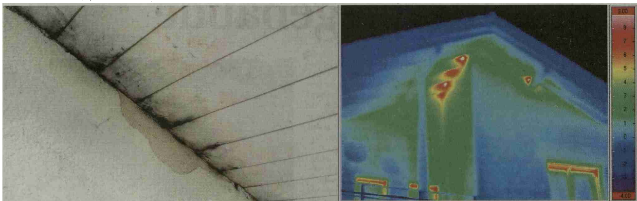
Bauschäden wie beispielsweise im Bild oben gilt es frühzeitig zu vermeiden.
