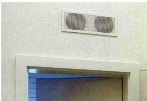
Der aktive Überströmer über der Schlafzimmertür signalisiert bei der EFH-Modernisierung in Uster die Präsenz einer Verbundlüftung.
