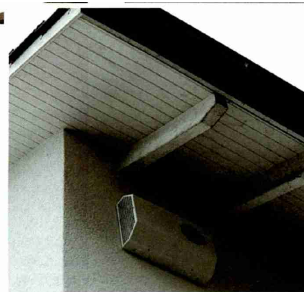
Aussenluft-Fassung und Fortluft-Auslass für die Verbundlüftung des im Artikel erwähnten modernisierten EFH in Uster erfolgt unter dem Dach.
