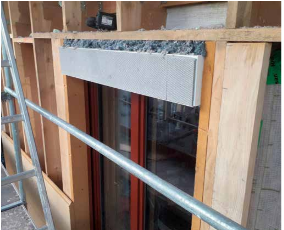
Ci-dessous, détails sur l'isolation en Métisse d'un coffre de volet roulant sur la menuiserie Bader.
