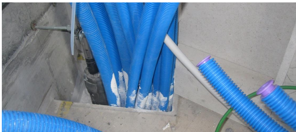
Illustration 10 : Inapproprié : installation électrique en faisceau (source : Haute école de Lucerne – Technique et architecture ; photo: 30.11.2013)
