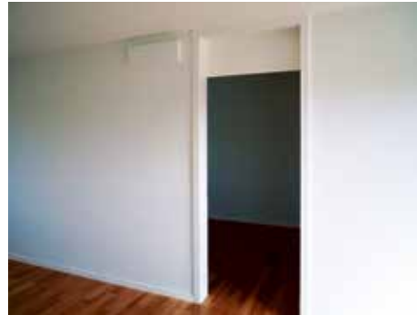
Der Verbundlüfter fördert Luft aus dem Wohnzimmer ins Schlafzimmer.
