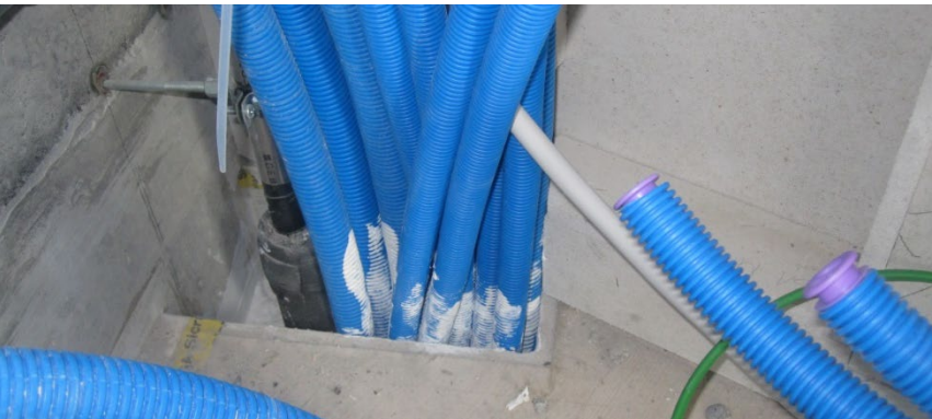
Figura 11: Non conforme: fascio di installazioni elettriche (Fonte: Hochschule Luzern – Technik & Architektur; Foto: 30.11.2013)
